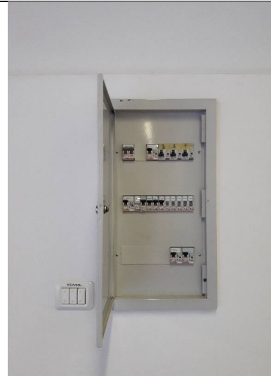
foto 2 – quadro elettrico salone
