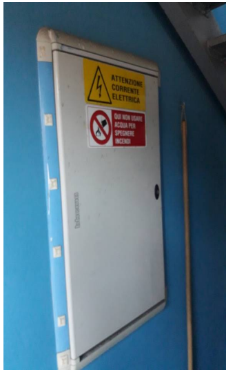
foto 3 – quadro elettrico generale
