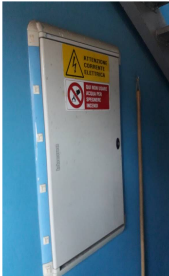
foto 3 – quadro elettrico generale
