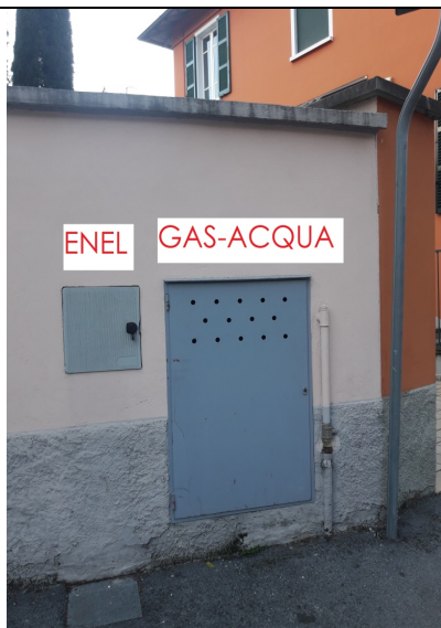
foto 5 – vani contatore ENEL, Gas, Acqua
