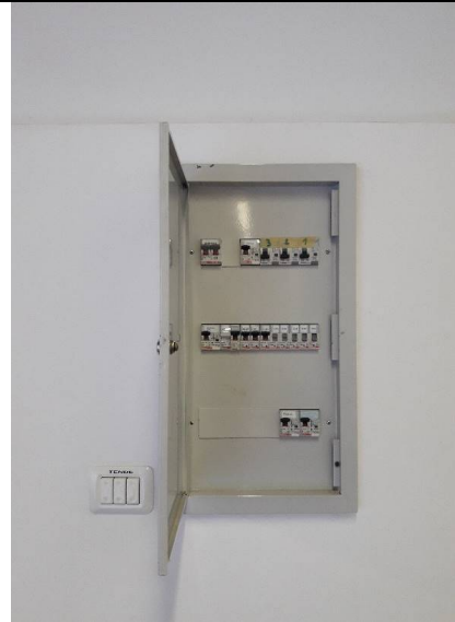
foto 2 – quadro elettrico salone
